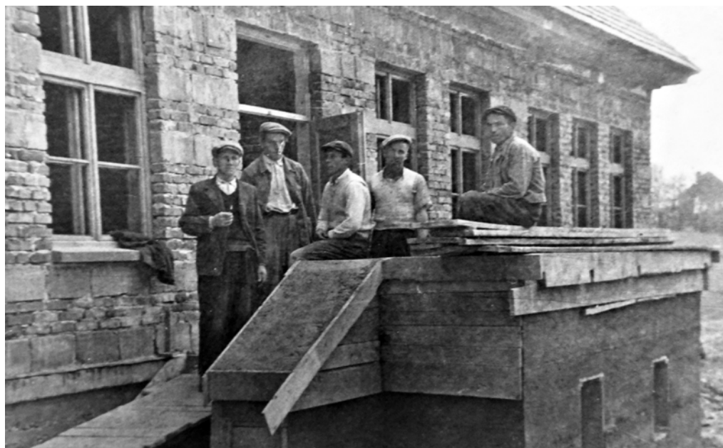
SZKOŁA NA PRZYSŁOPIU STAN SUROWY
